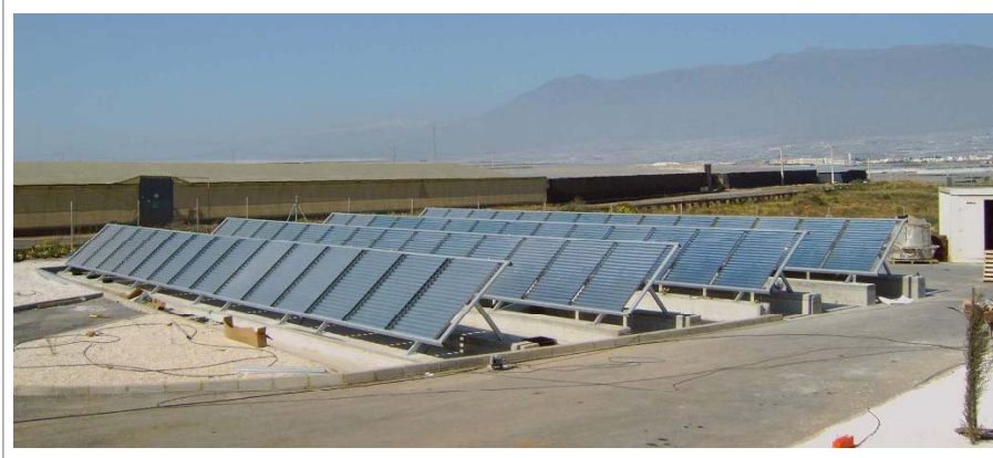
Figura 15. Vista del campo de captadores solares CPC (150 m 2 de superficie total). La planta se encuentra operativa desde el año 2004.
