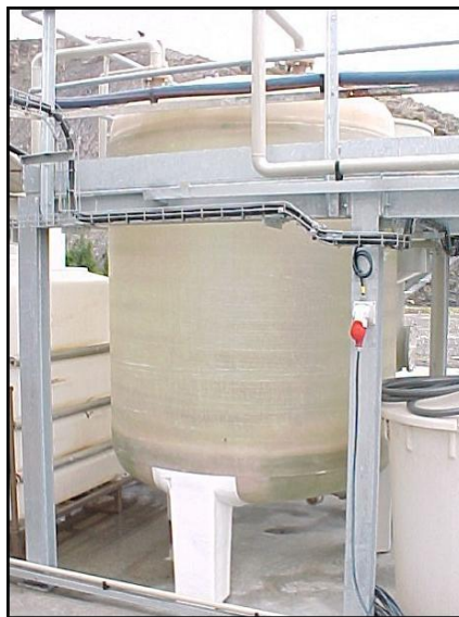
Figura 4.40. Fotografías del sistema de tratamiento biológico aerobio. En la fotografía de arriba se muestra el tanque de acondicionamiento (izquierda) y RLF (derecha). En la fotografía de abajo se muestra el tanque de neutralización.
