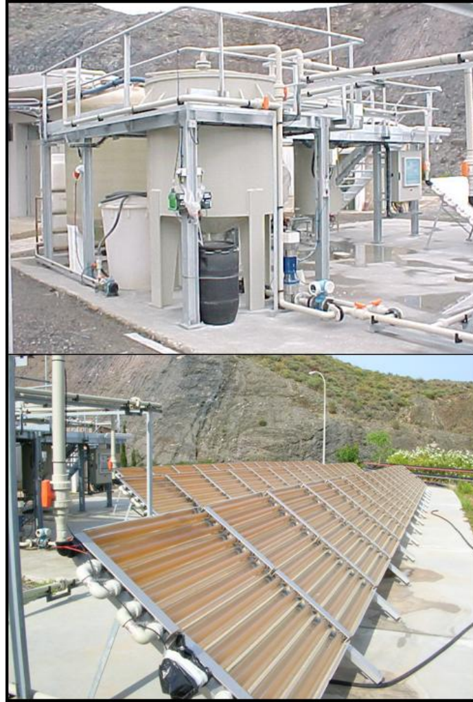
Figura 4.39. Fotografía del tanque de recirculación correspondiente al reactor fotocatalítico (arriba) y vista del campo de captadores solares durante un experimento de foto-Fenton (abajo).
