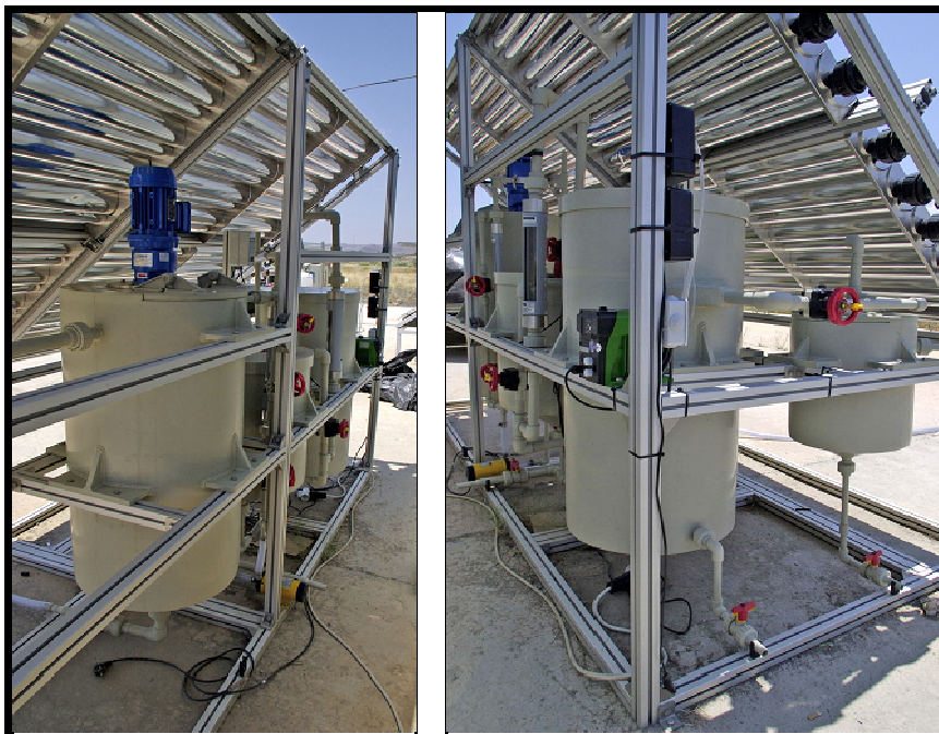
Figura 3.16. Fotografías del reactor biológico aerobio RLF-II a escala planta piloto construido dentro del marco del proyecto CADOX.
