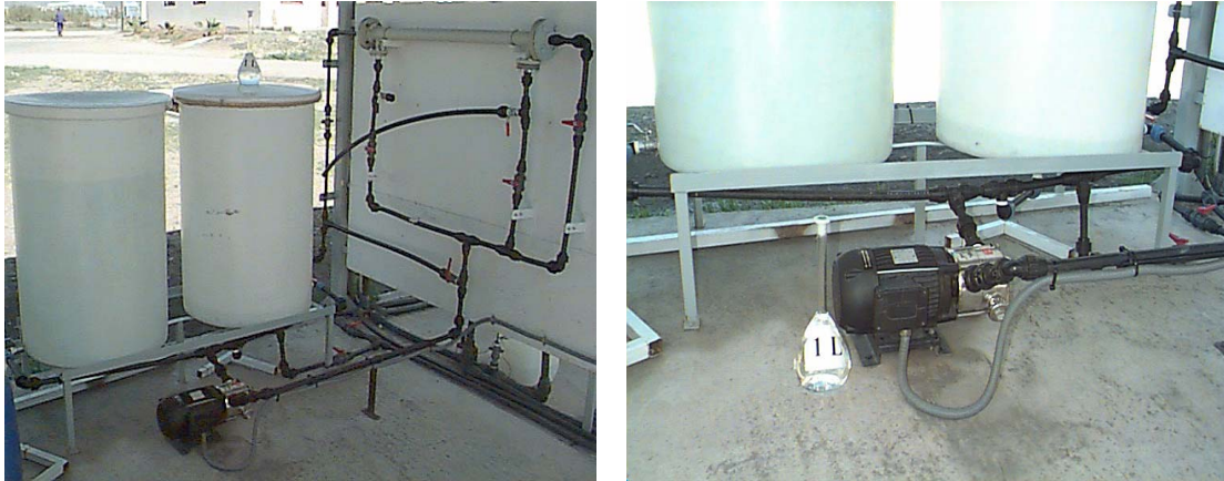
Figura 2.30. Fotografías de los tanques de sedimentación y filtración (izda.) y de conexión a la bomba centrífuga (dcha.) tomadas en la PSA.
