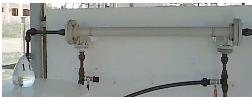
Figura 2.31. Fotografía de sistemas de microfiltración tomada en la PSA.
