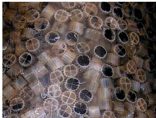
Figura 1. 5. Sistema de fangos activos adheridos a soportes de polipropileno en el interior del RLF.
