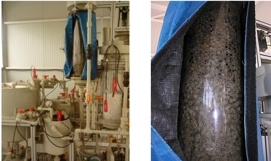
Figura 4. 13. Reactor biológico de lecho fijo.
