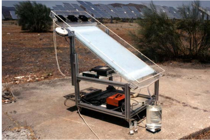
Figura 1.3.12. Instalación experimental de un colector de placa plana utilizado por el ISFH (Institut für Solarenergieforschung GmbH, Hannover, Alemania) en las instalaciones de la PSA.
