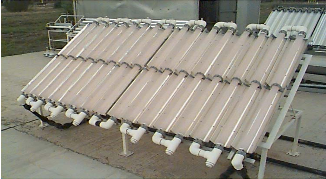
Figura 2.1.5. Pareja de módulos CPC de la planta piloto montados en plataforma fija a 37^\circ sobre la horizontal.
