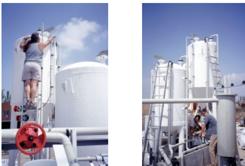
Fig. 7.19.- Instalación de los depósitos principales de la planta. Izquierda: instalación del sensor de nivel en el depósito de sedimentación del catalizador. Derecha: vista general de los diferentes depósitos con el de recirculación ( 100\text{ L} ) en primer término y el de almacenamiento ( 2\text{ m}^3 ) inmediatamente detrás
