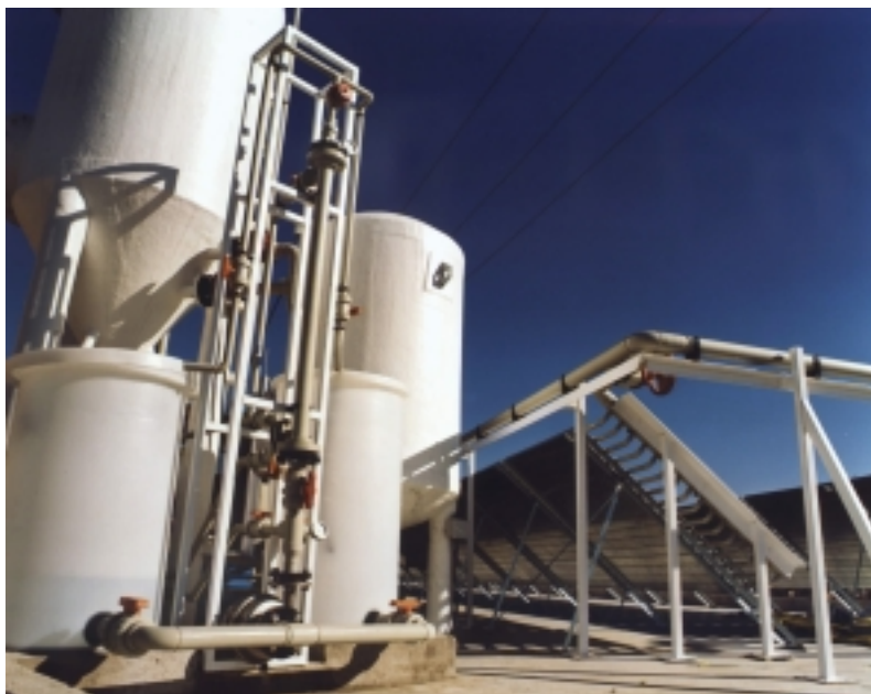
Fig. 7.32.- Vista del sistema de recuperación del TiO_2 mediante proceso de sedimentación acoplado con filtración del sobrenadante
