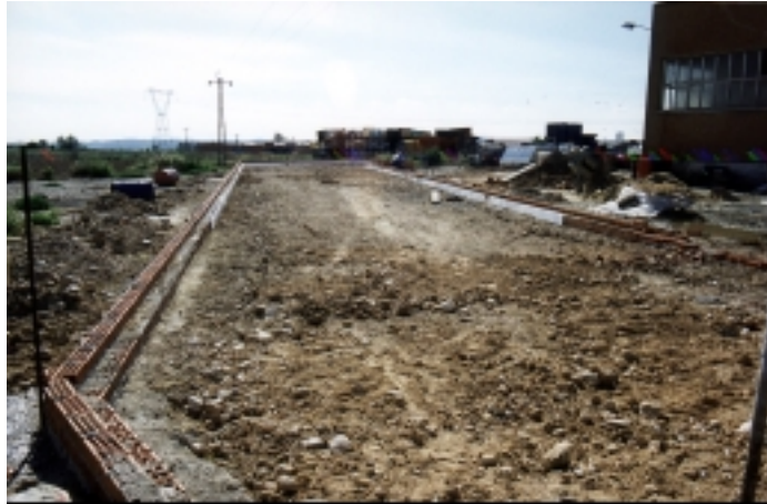
Fig. 7.17.- Obra civil. Preparación del terreno y construcción de la cimentación de la planta
