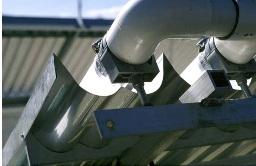
Figura 5.16.- Vista de un colector CPC con factor de concentración cercano a la unidad (PSA) para aplicaciones de fotocatalisis
