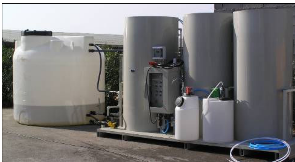
Figura 2.13 Fotografía del IBR instalado en ALBAIDA RESIDUOS S.L.
