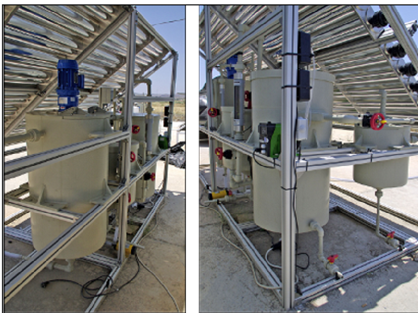
Figura 2.9 Fotografías del IBR instalado en la PSA
