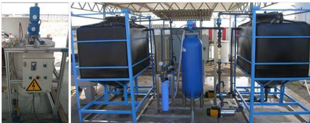
Figura III.24. Fotografía del sistema de coagulación/floculación/filtración diseñado e instalado por S.E.T.A.
