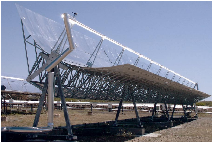
Vista del prototipo de colector EUROTROUGH instalado en la PSA
