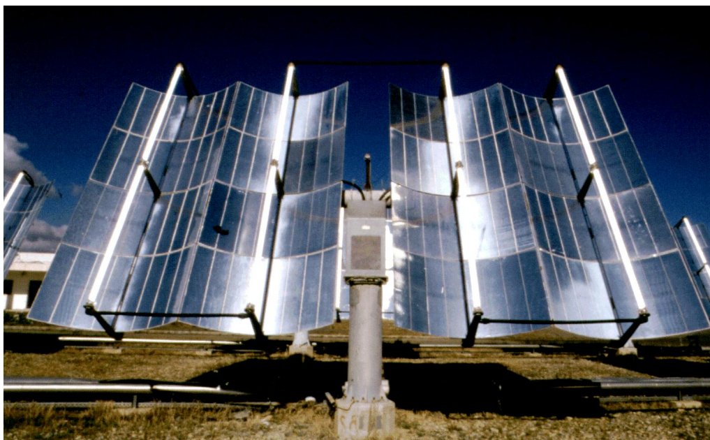
Figura 15. Colector cilindro-parabólico con seguimiento en dos ejes instalado en la PSA.
