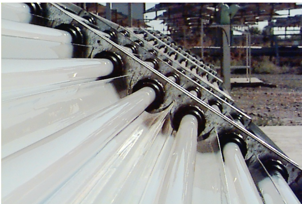
Figura 21 Detalle de un colector CPC donde se observa la configuración de los tubos reactores.
