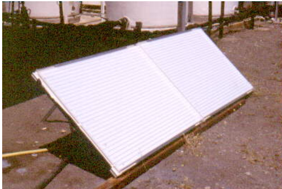
Figura 17. Instalación experimental de un colector de placa plana hueca construido a partir de materiales plásticos.
