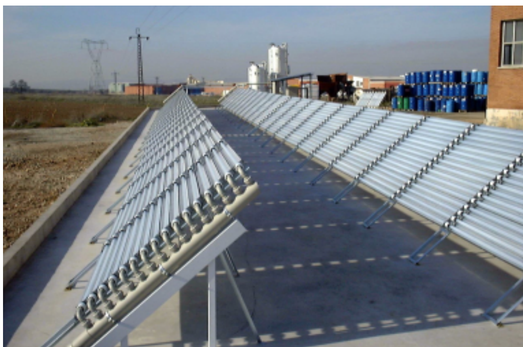
Figura 24. Planta experimental industrial de Fotocatalisis Solar (Arganda del Rey, Madrid), con un campo solar de 100 \text{ m}^2 de colectores CPC.
